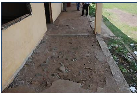
教室外の廊下はコンクリートが割れ、 土がむき出しになっています
