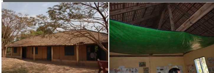
写真② ボンクアイ小学校 屋根の瓦が割れていて大穴が空いている。天井にシートを張って瓦の落下を防いでいます
