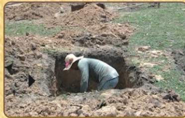
2 穴を掘って鉄筋を埋め、床の鉄筋コンクリート工事を行う
