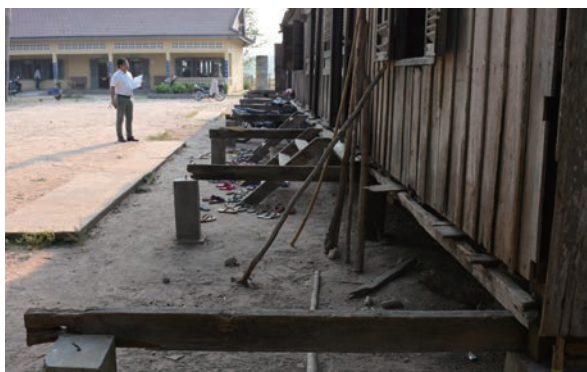
②木造が腐食して倒壊の恐れあり
