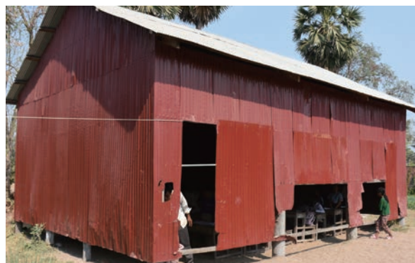
③屋根も壁もトタンで暑すぎて授業できない
