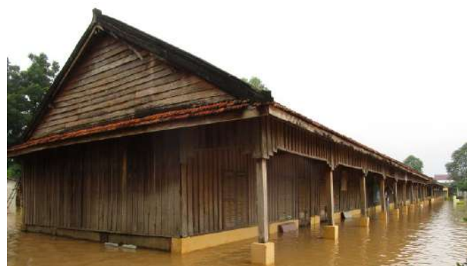
ワットコー小学校 洪水で水浸しになった様子
